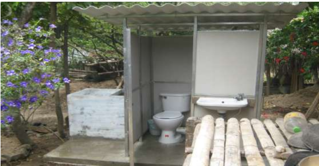
Municipio de Coyaima Vereda Chenche Buenavista: Avance de obra Construcción de Sistemas Sépticos
